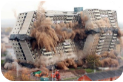
Figura 45: Colapso de un edificio (Créditos: Builders Enquiry)
